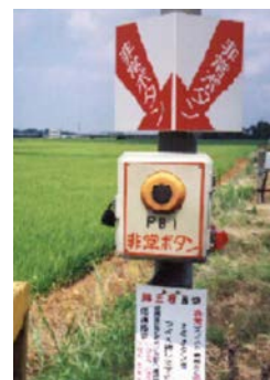
踏切支障報知装置
