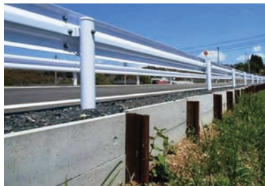
道路端部の土留用RC板と被災レール杭
