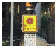
踏切非常ボタン
