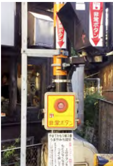
踏切支障報知装置(非常ボタン)
