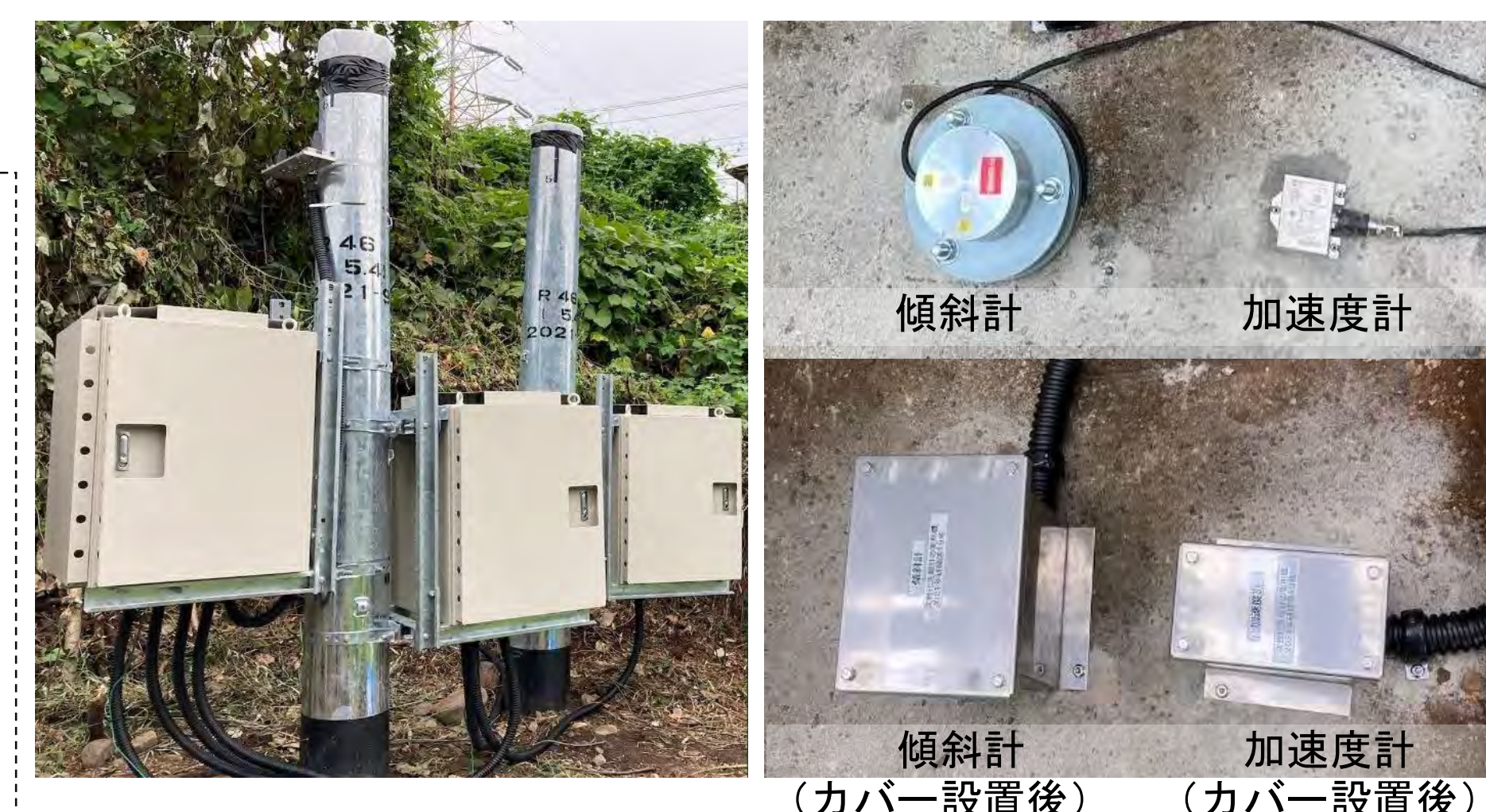
制御部 写真1 試作品（実橋りょう設置） センサ部
