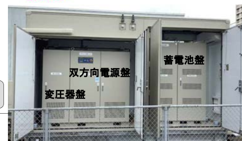
現地の非常用蓄電システム
