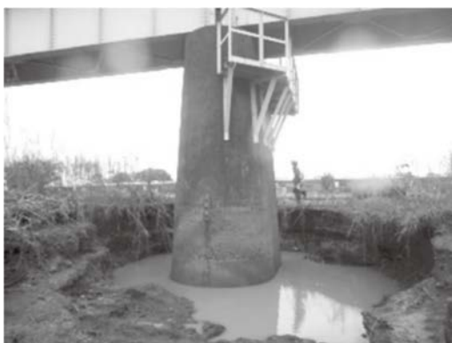
図1 橋脚周りの洗掘の例
