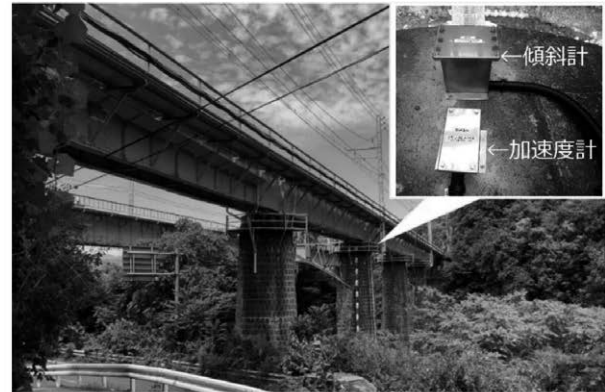
図12 次世代洗掘計を設置した営業線橋りょう全景
