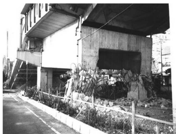
(b) RCラーメン橋台のせん断破壊
