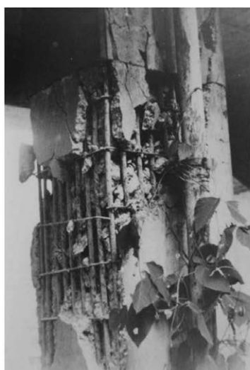
(a) RC高架橋柱の被害
