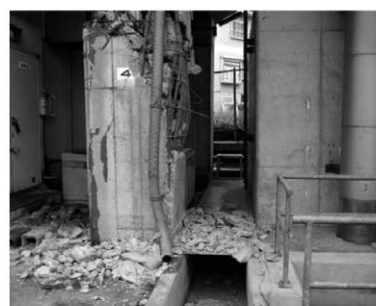
(c) RC高架橋柱が拘束された箇所の被害
