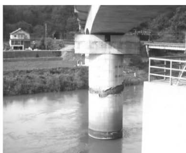
(b) 橋脚の鉄筋段落し部の損傷
