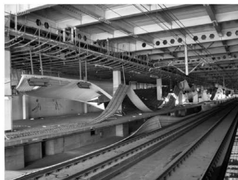
(b) 駅天井の破損
