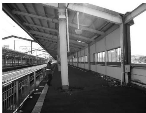
(c) 高架橋上の上家被害
