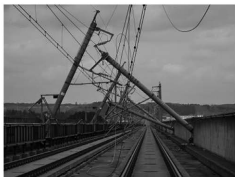
(a) 電柱の被害
