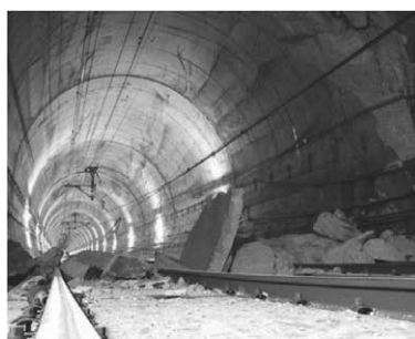
(a) トンネルの被害
