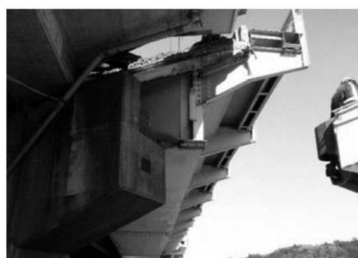
(d) 斜角桁の桁ずれ
