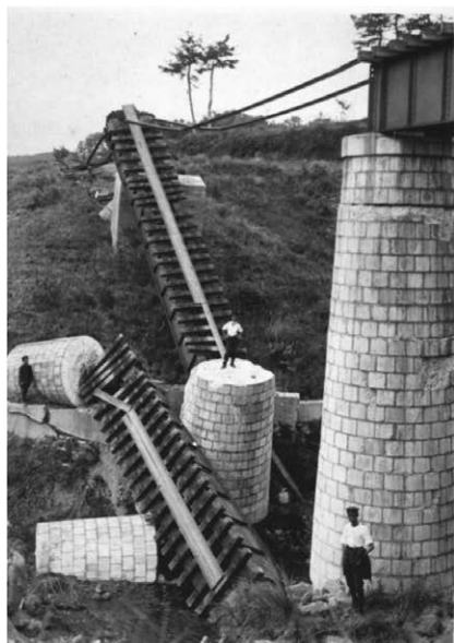
(a) 橋脚の破損 1)
