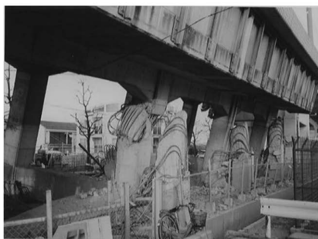
(a) RC高架橋柱のせん断破壊
