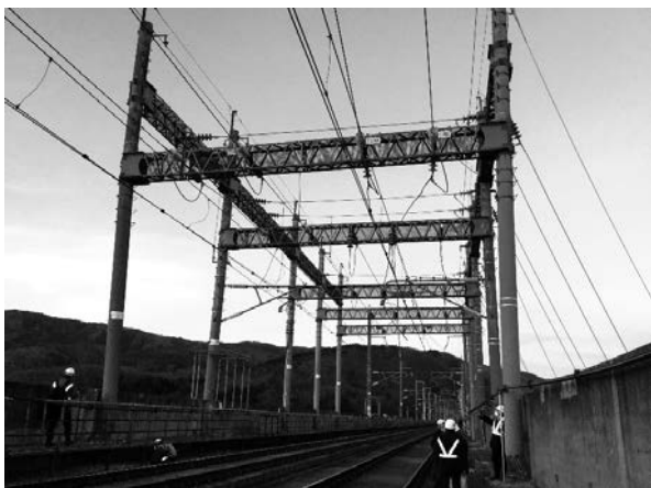
写真3 福島県沖地震後の状況
