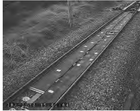
図6 奥羽本線大石田駅の温水マット
