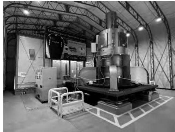
図4 超電導フライホイール蓄電システムの外観
