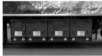
図3 主回路蓄電池 (1号車)
