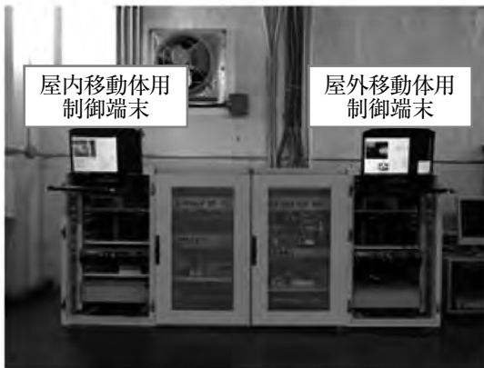
図4 制御端末(変電所側)
