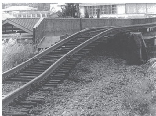
図1 橋台背面盛土の被災事例(新潟県中越地震) 1)
