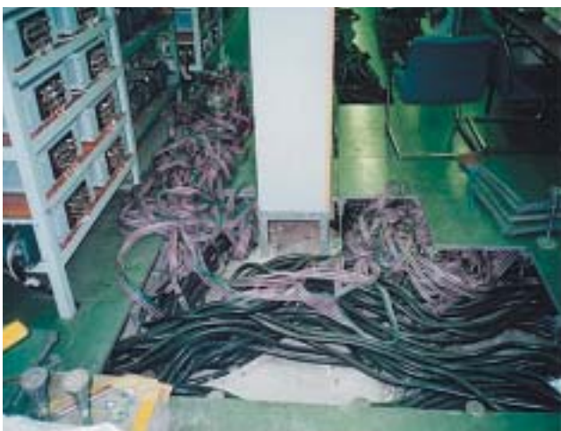
図11：現在の機器室内のケーブル状況
