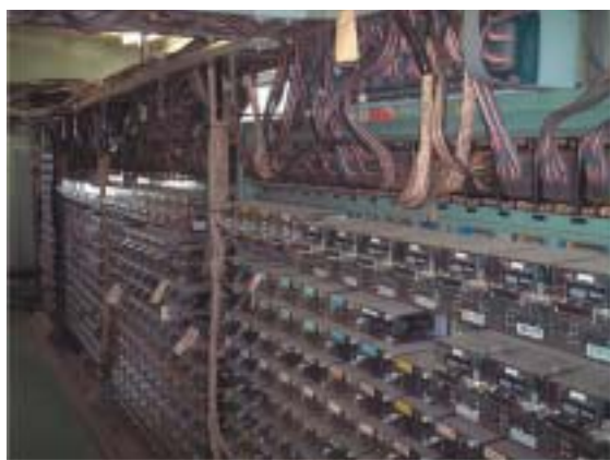
図7：継電連動装置
