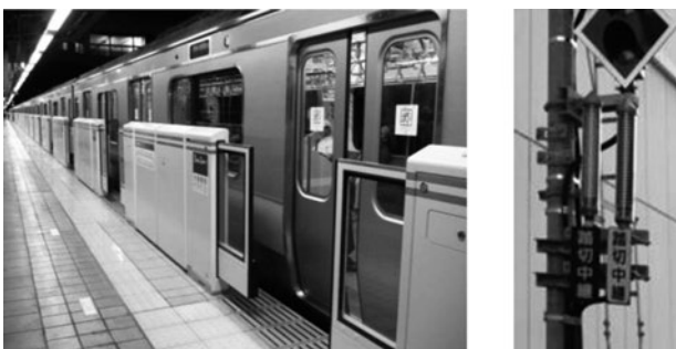
写真 ホームドア・踏切支障報知装置
