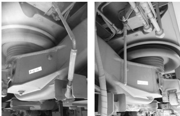
図4 地震動を受けた車両が大きくローリング挙動して、空気ばね高さ調整弁連結棒が損傷した事例
