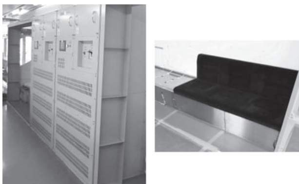
図2 主回路蓄電池の搭載状況 (左：縦型搭載、右：座席下搭載)
