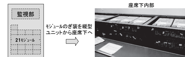
図10 座席下に収納した蓄電池
