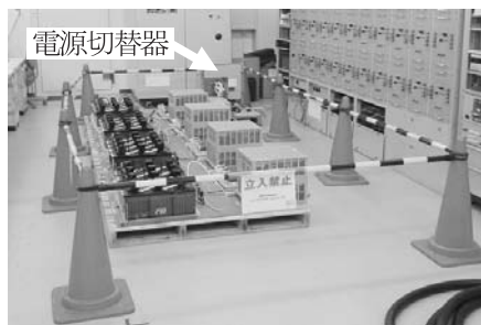
図2 試験設備設置状況（実験棟信号試験室）
