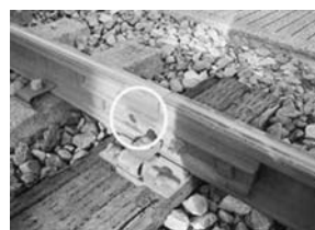
継目板ボルトの脱落
