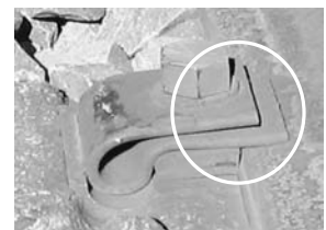
レール締結装置の緩み
