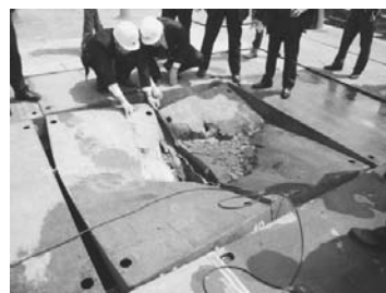
図17 覆工板損傷状況
