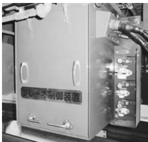
図8 ブレーキ制御装置 (A方式)
