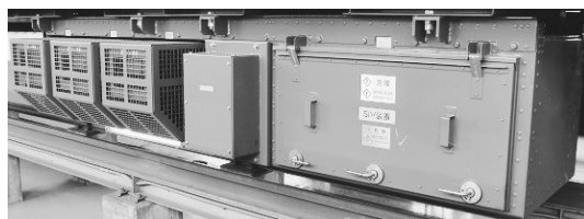
図5 補助電源装置 (A方式)
