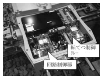
図7 転てつ制御リレー（右）回路制御器（左）
