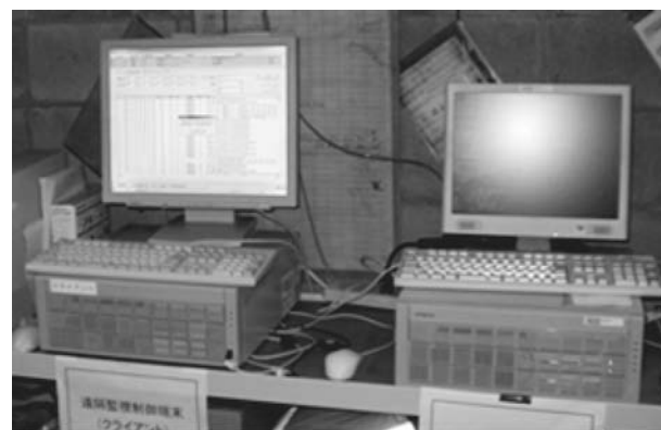
図10 遠隔監視制御端末（左）と遠隔制御サーバ（右）
