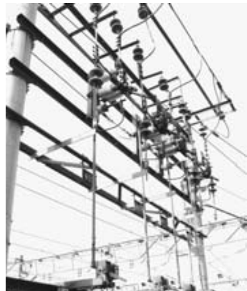
図2 直流手動断路器の設置状況
