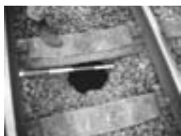
図1 路盤陥没発生状況
