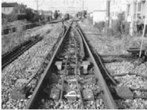
図16 信越本線（上）羽生田駅構内22号分岐器
