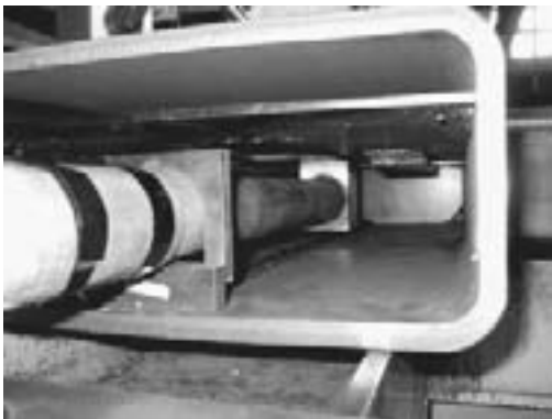
図11 グリッドまくらぎ内部の配管
