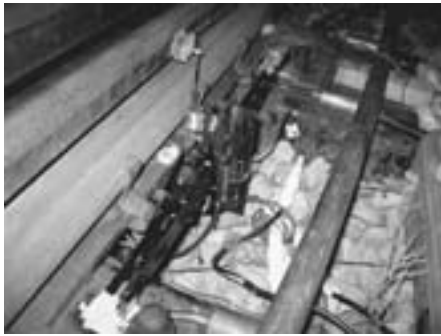
図21 レール変位センサー取付
