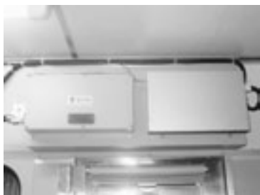
図10 E231系運転台への設置状況（左：検知装置 右：記録装置）
