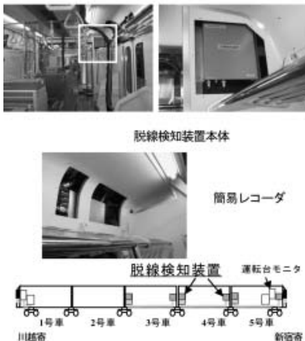
図9：ACトレイン脱線検知装置搭載箇所
