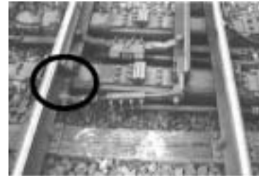
図13：現行フロントロッド肘金折損
