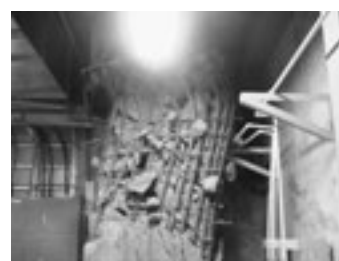
図3 柱の損傷状況
