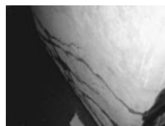
図5 柱基部の曲げひび割れ
