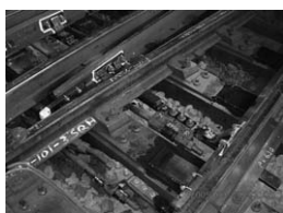
DSSポイント部
