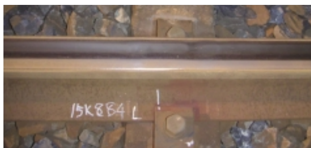
図3：レール溶接部の外観（上から）
