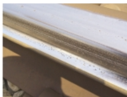
図8：摩耗が進行したレール
