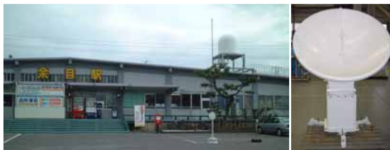
図3．余目駅屋上に設置したドップラーレーダー（右：ドップラーレーダー本体）
