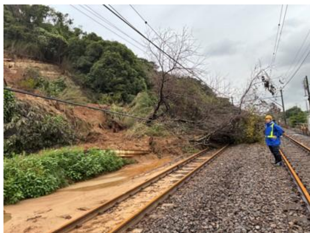
復旧工事着手前
