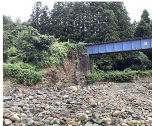
鶺鴒～瀬見温泉間 河川脇盛土崩壊箇所
