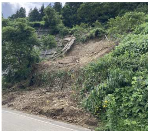
東長沢～長沢間 盛土崩壊・道路へ土砂流入箇所
