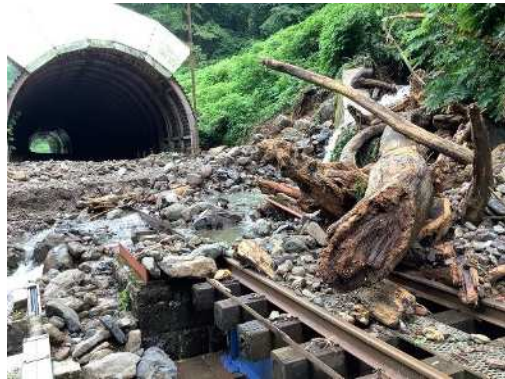
陸羽東線 瀬見温泉～東長沢間 土砂流入
