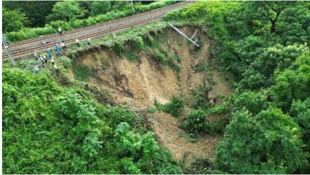
奥羽本線 芦沢～舟形間 のり面崩壊
