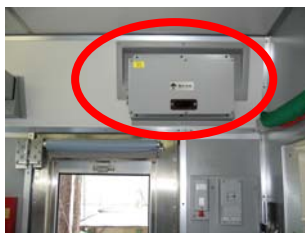
防護無線自動発報装置
