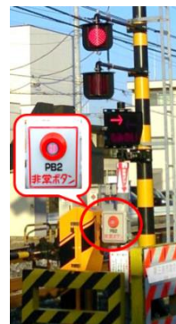
踏切安全対策
