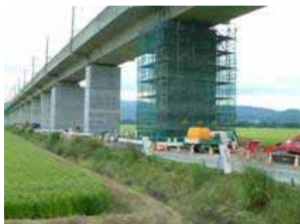
自然災害対策(地震対策)
