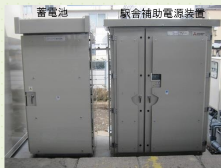
蓄電池付駅舎補助電源装置
