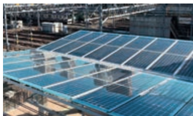
太陽光発電設備の導入(高輪ゲートウェイ駅)
