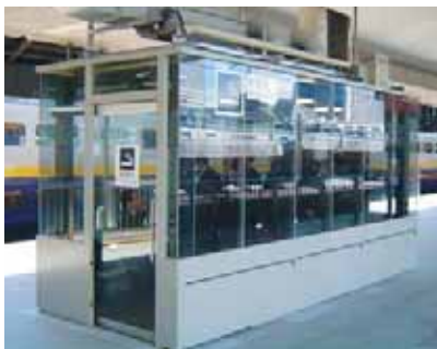
一部新幹線ホームに設置した、排煙設備を備えた喫煙所
