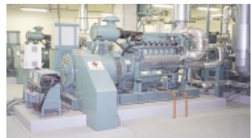
コージェネレーションシステム
