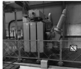
図2 供試体変圧器の写真
