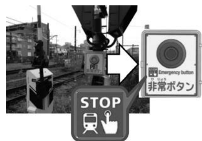
写真11 踏切支障報知装置
