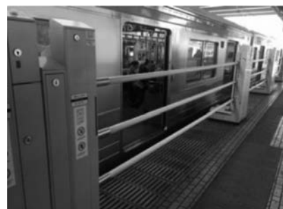
写真8 昇降式ホーム柵（八高線拝島駅）
